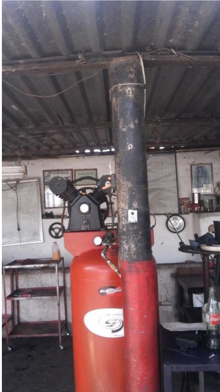
En esta imagen se muestra que no contamos con extintor de fuego
